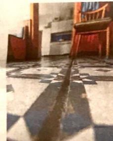
Ein Bau- oder Bergschaden? Das ist hier die Frage. FOTO: MARKUS WEISSENFELS
